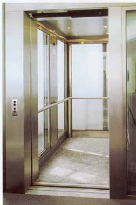
Εσωτερική άποψη πανοραμικού θαλάμου σε κέντρο καταστήματων
